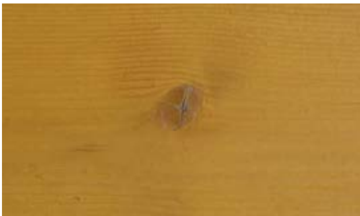
Fig. 2.1 : Stade de dégradation par les intempéries 1
