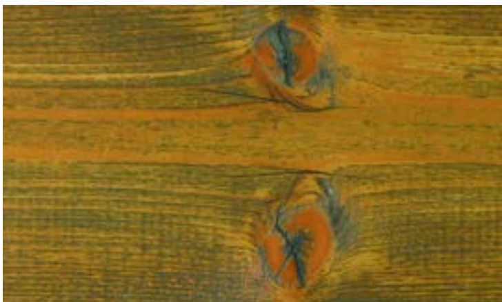
Fig. 2.3 : Stade de dégradation par les intempéries 3
